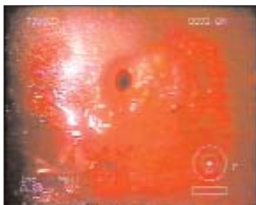
Fig.2: Particolare della corrosione in un tubo in acciaio
