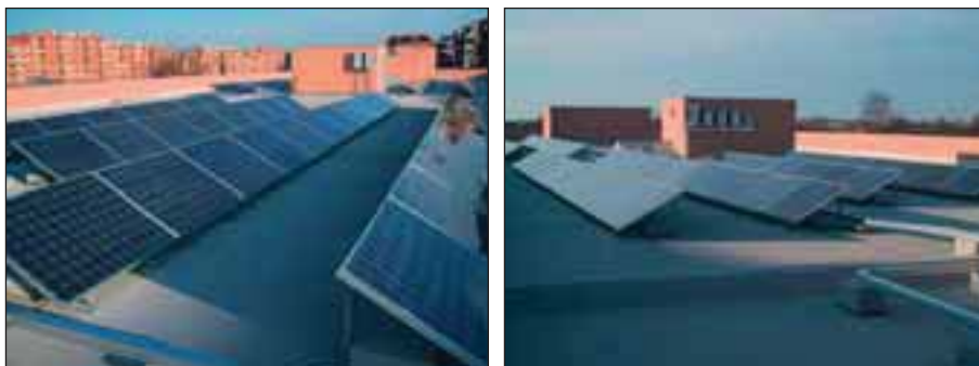
Foto delle stringhe dell'impianto fotovoltaico connesso alla rete, installato sul tetto piano della scuola, con potenza massima di 20,13 kWp
